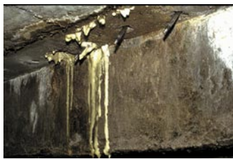
Zdjęcie 1: Przykład zastosowania spienialnej żywicy poliuretanowej zatrzymującej wycieki wody pod ciśnieniem.
