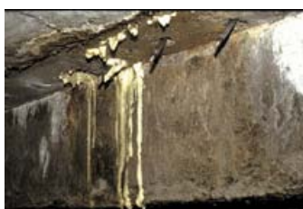
Zdjęcie 1: Przykład zastosowania spienialnej żywicy poliuretanowej zatrzymującej wycieki wody pod ciśnieniem.
