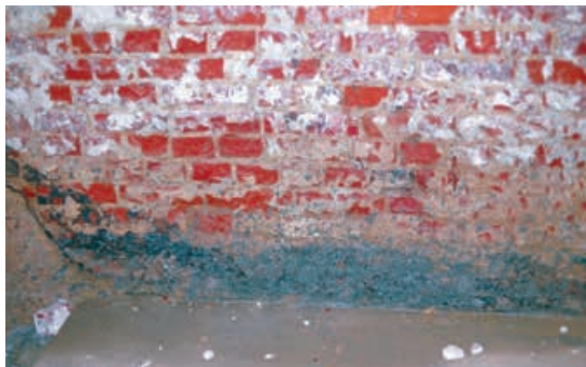
Zawilgocony i zasolony mur
