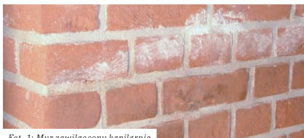
Fot. 1: Mur zawilgocony kapilarnie
