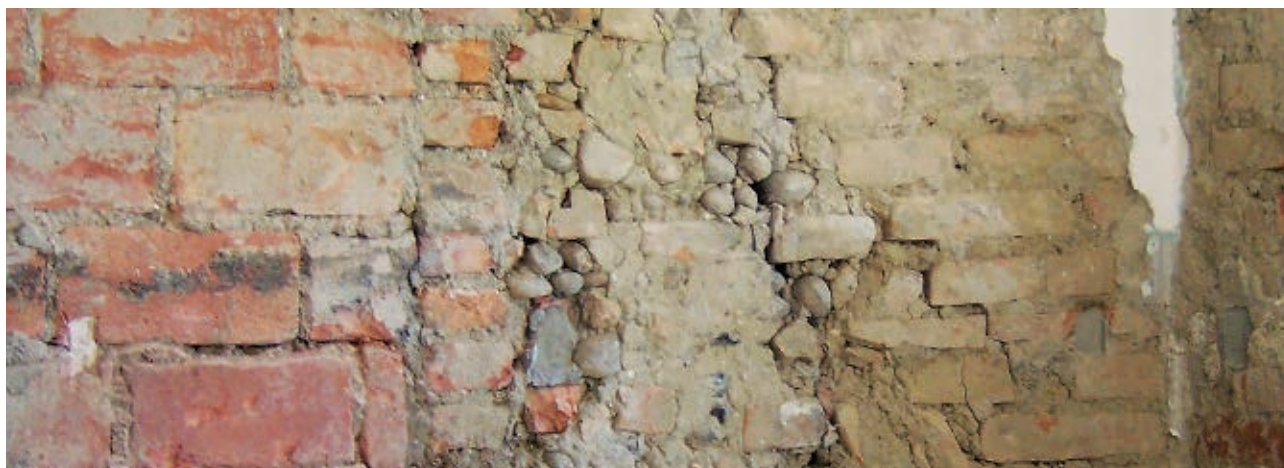
Szkody w murze mieszanym
