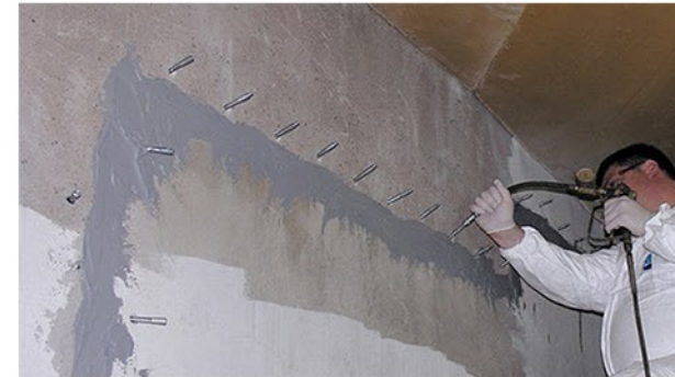
Rys. 5 Przykładowy sposób naprawy liniowego spękania konstrukcji z wykorzystaniem żywic epoksydowych WEBAC
