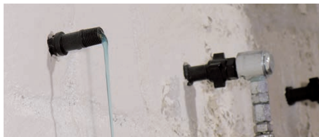
Wyciek żelu z sąsiedniego iniektora
